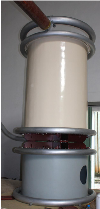
Hình 3.1: Bộ điện kháng cao áp
